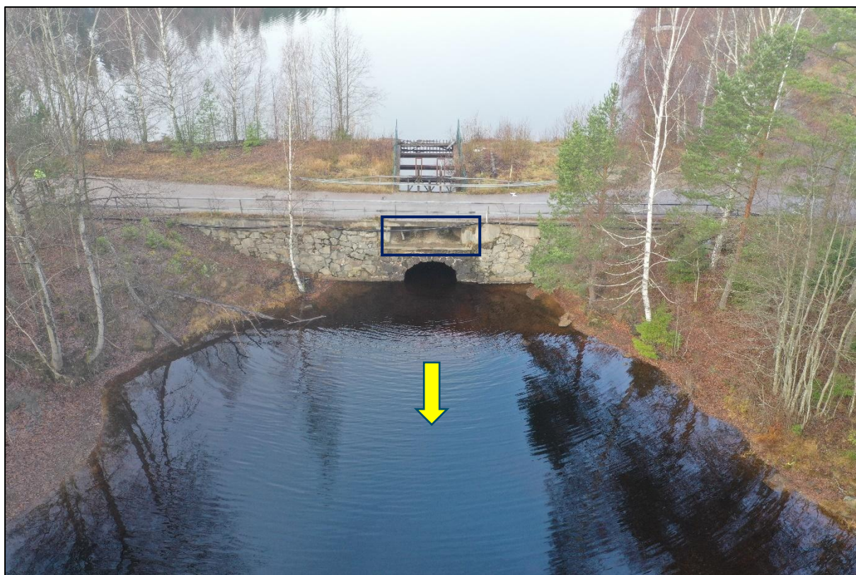
Figur 8.1. Liens regleringsdamm sedd från nedströmssidan. I bilden syns det äldre utskovet i den kallmurade bron. Skibordet för höglöden som syns lite sämre är markerat med mörkblå rektangel.
