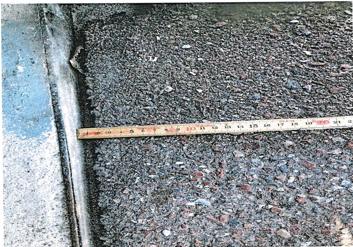
Springa mellan asfalt och garagegolv
